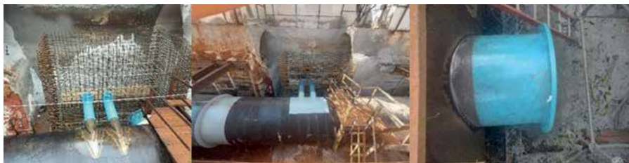
Figura 15 - Caixa de válvulas da ventosa
